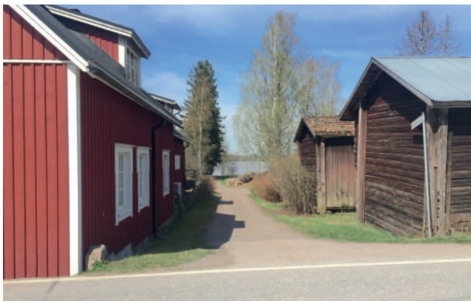
21. Saarelankuja Tuomalan kylässä Rantatien länsipuolella. Tien tasauksen nousun vuoksi vasemmanpuoleisen rakennuksen kivijalka on jäänyt kokonaan tien sisään. Myös oikeanpuoleinen aitta lahoaa tien pinnan nousun vuoksi. Samalla kujan liittyminen Rantatiehen on tullut jyrkäksi. Rakennukset estävät kujalta ajavia näkemästä Rantatien liikennettä, ja jyrkkä nousu Rantatielle lisää liittymän vaarallisuutta.
